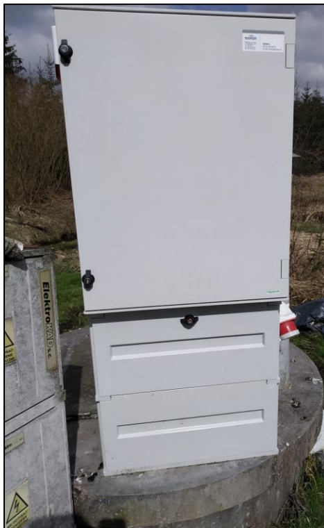
Fotografia 4.1.12 Nowa szafa sterująca przepompownią ścieków Istebna Andziołówka
