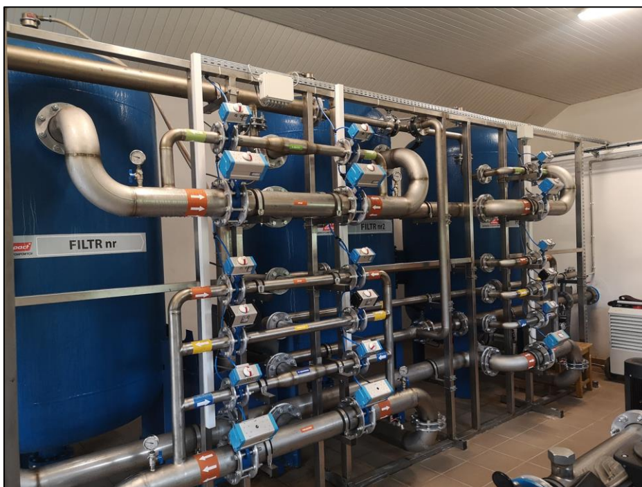
Fotografia 4.1.5 Stacja Uzdatniania Wody Koniaków Jasiówka – trzy filtry pośpieszne z automatyką
