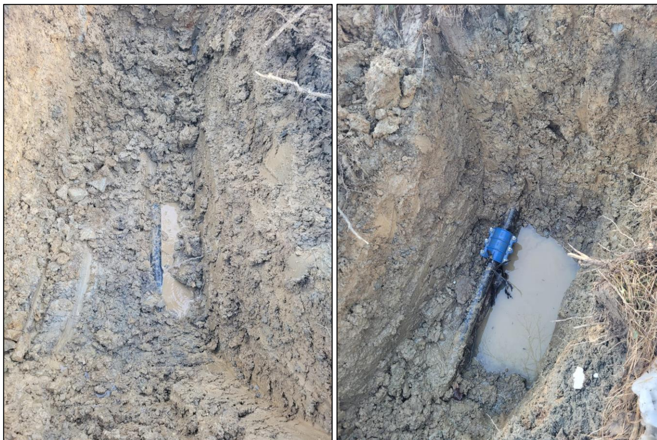
Fotografia 4.1.3 Z lewej: awaria na wodociągu stalowym DN 80 Istebna Beskid; Z prawej: usunięcie awarii poprzez założenie opaski ściągającej DN 80 Istebna Beskid.
