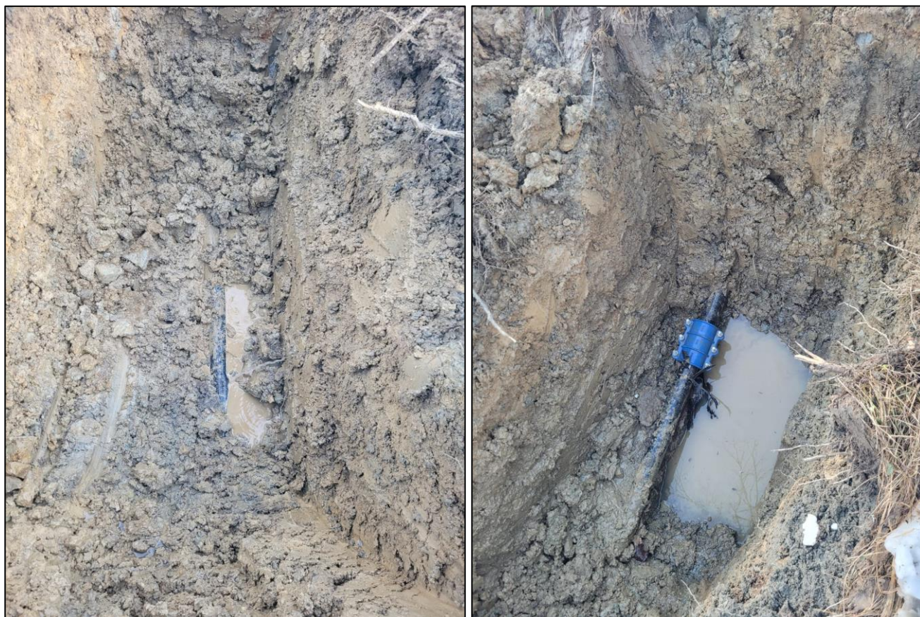
Fotografia 4.1.3 Z lewej: awaria na wodociągu stalowym DN 80 Istebna Beskid; Z prawej: usunięcie awarii poprzez założenie opaski ściągającej DN 80 Istebna Beskid.
