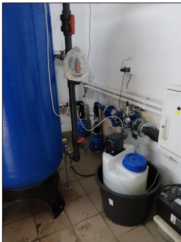
Fotografia 4.1.7 Armatura wodociągowa wraz chloratorem na stacji uzdatniania wody Jaworzynka Krężelka
