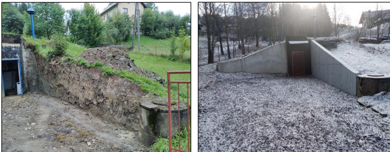
Fotografia 4.1.10 Z lewej: rozbiórka starego muru oporowego z prawej: w tle Suw Koniaków Bukowina z nowym murem oporowym.
