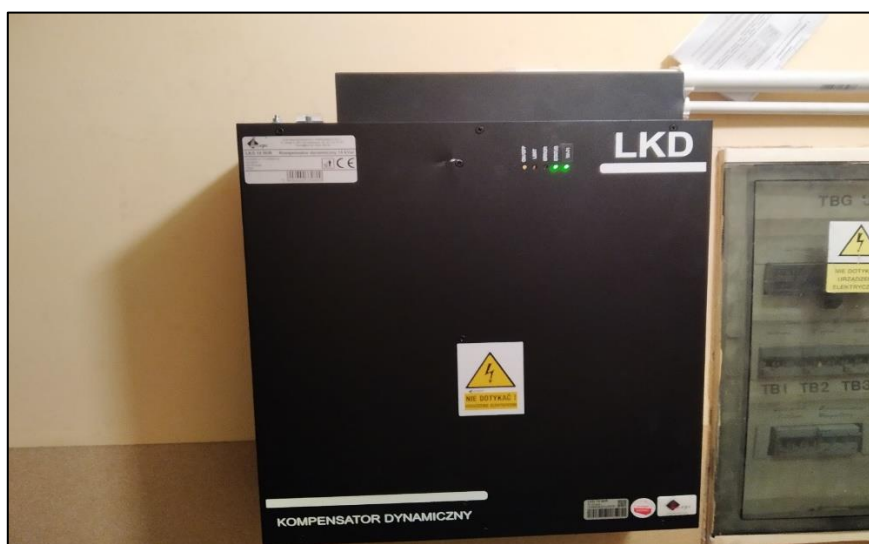
Fotografia 4.1.13 Zamontowany na ścianie budynku UG Istebna kompensator energii biernej.
