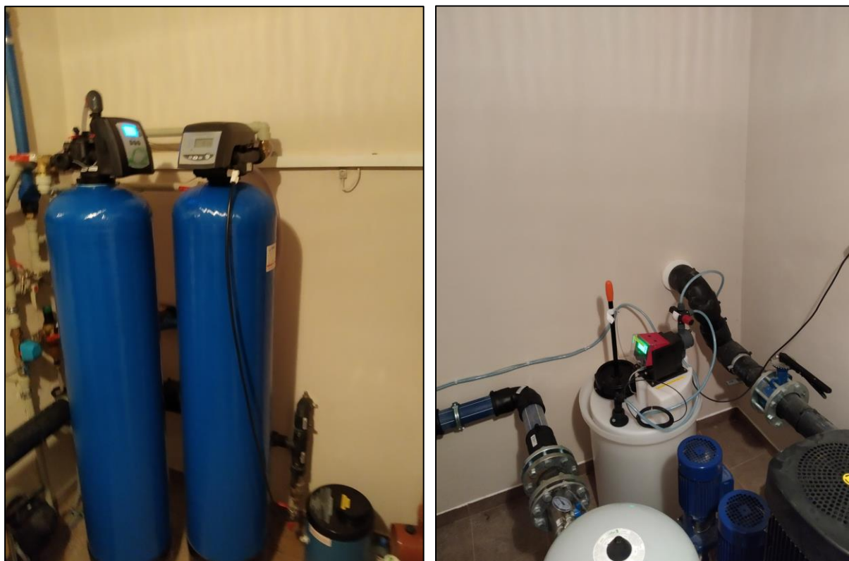
Fotografia 4.1.11 Z lewej: nowe filtry do odżelaziania i odmanganiania wody z prawej: zestaw do uzdatniania wody poprzez dawkowanie chloru.
