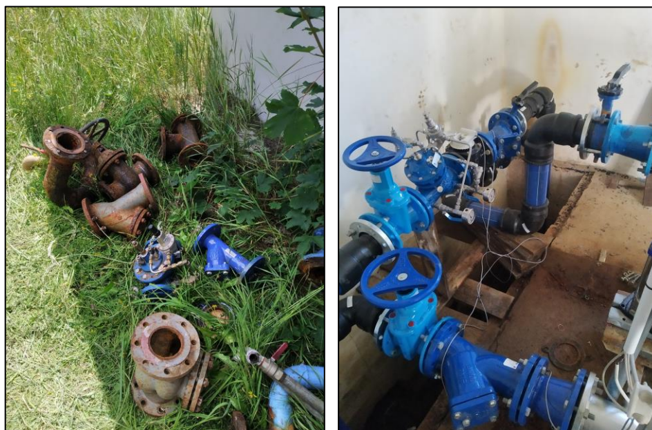
Fotografia 4.1.9 Z lewej: zdemontowana armatura wodociągowa z prawej: nowa zamontowana armatura wodociągowa na przepompowni
