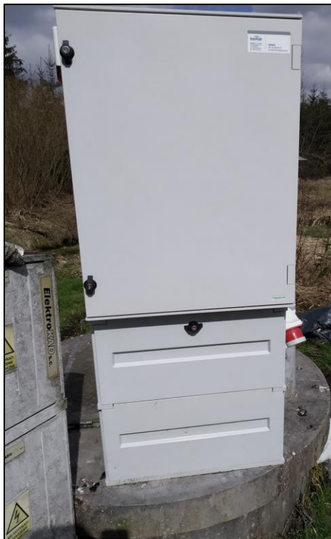
Fotografia 4.1.12 Nowa szafa sterująca przepompownią ścieków Istebna Andziołówka
